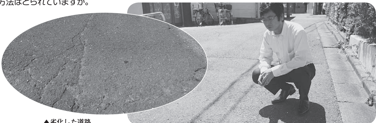
▲劣化した道路
